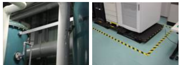
タンクの連結例 免震台上のサーバ 写真8 地震対策の例
