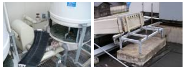
写真3 クーリングタワーや室外機の破損状況
