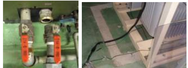
右配管の破損 トランスラックの移動 写真7 相対変位による破損例
