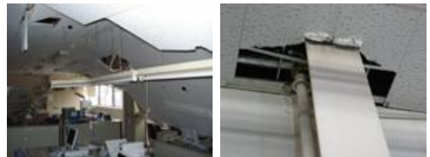
写真2 天井の破損状況
