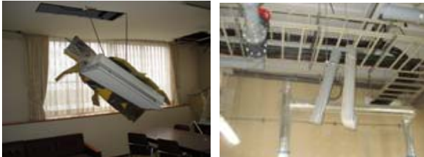
写真4 破損した天井エアコンと塩ビ製配管
