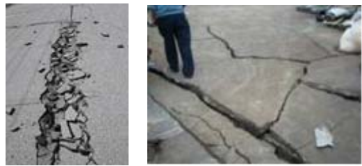
写真1 道路のひび割れや段差
