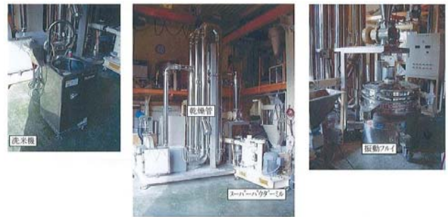
Fig. 2 製粉システムの主要装置
