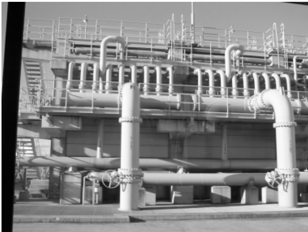
図3 LNGをガス化する気化器
