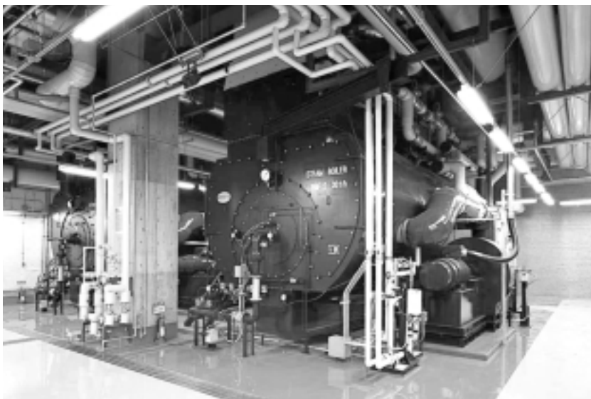
図4 大型蒸気ボイラ
