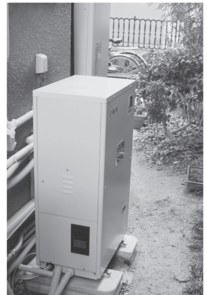
図 3 戸建住宅での設置運用試験
