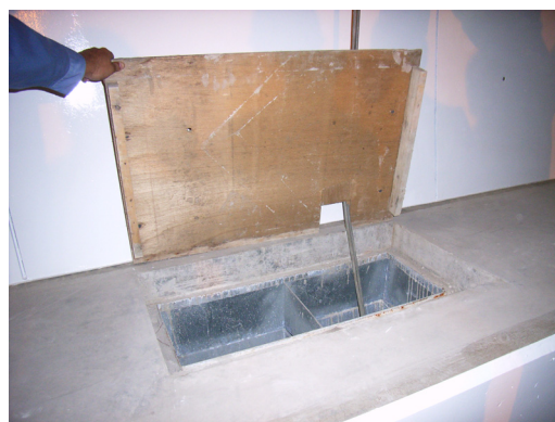
Fig. 3 換気用空気送風口
