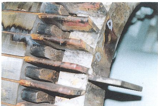
ロータバー57本中 7本折損
