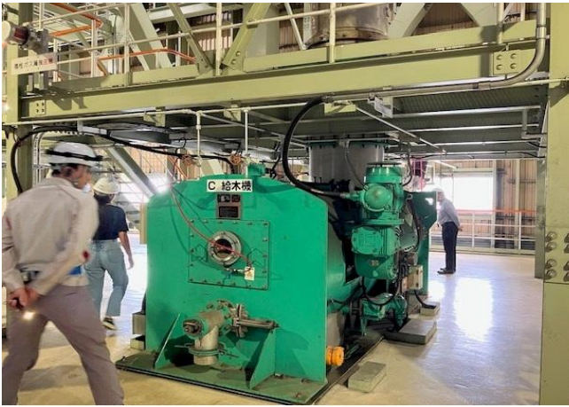
バイオマスをミルに供給するフィーダ
