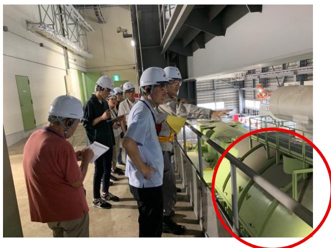
迫力ある蒸気タービンを階上から 右下は低圧タービン
