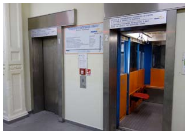
図5 ジェノバの公共エレベーター
