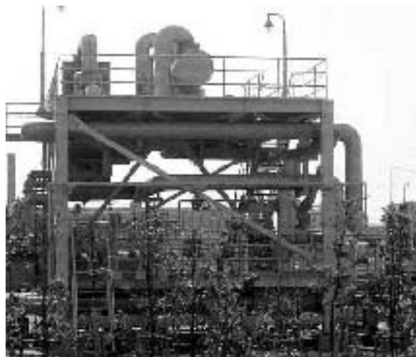
LNGBOG再液化設備
