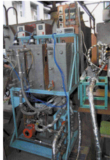
図2 燃料加熱供給装置
