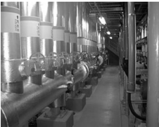
図2 裏側には上へ下へと配管が続く
