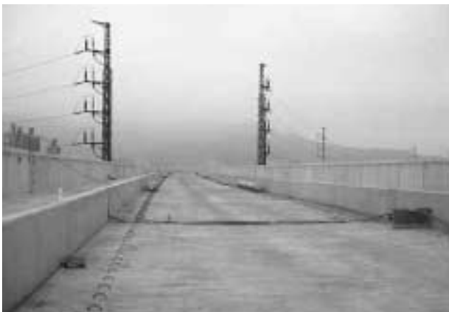
図6 高圧電線を切断する高架橋
