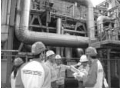
図11 高速2軸型蒸気タービンCDQ3号
