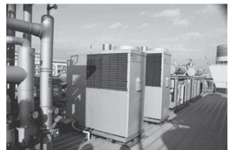
図1 屋上に設置されたガスエンジン
