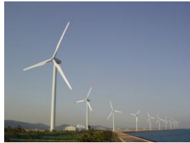
エヌエスウインドパワーひびき
