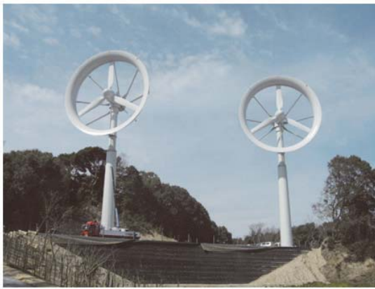
図4 100kW レンズ風車、ロータ径 12.8m、レンズ径 15.4m
