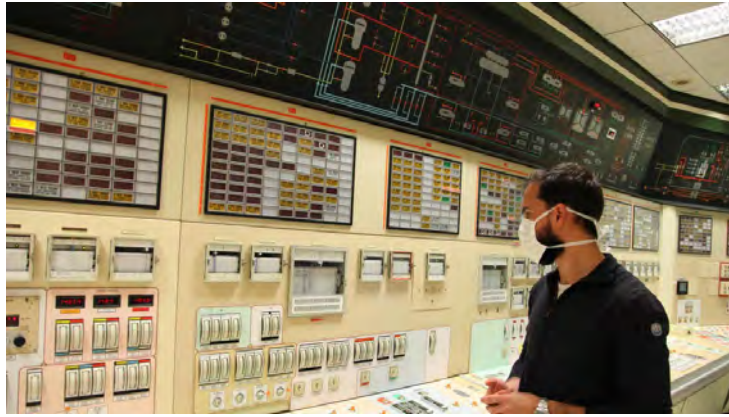
図 3.2-7 制御室内の様子
