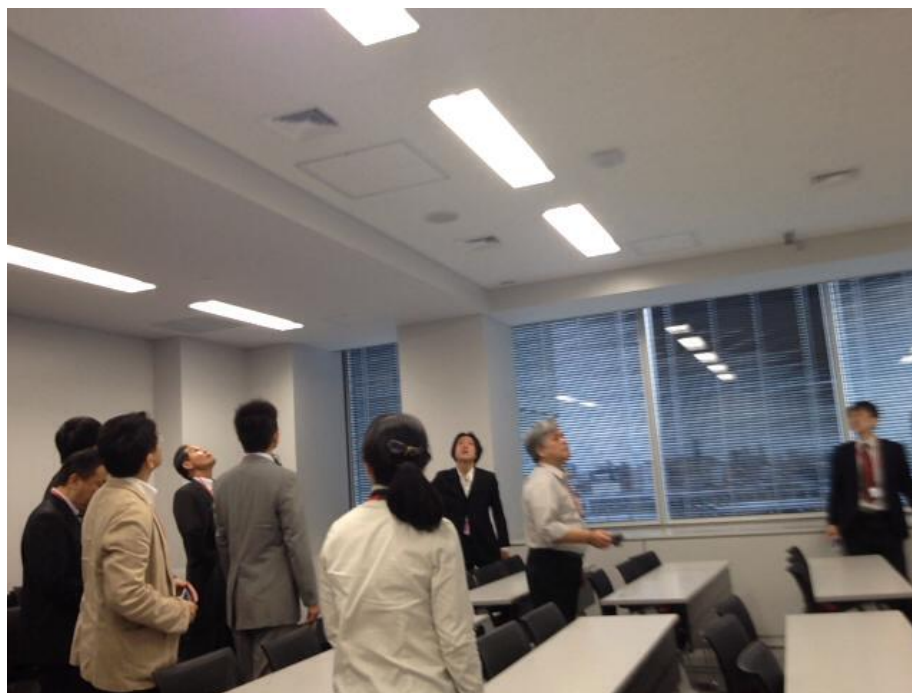
東京電機大学の天井のスポット吹き出し冷房
