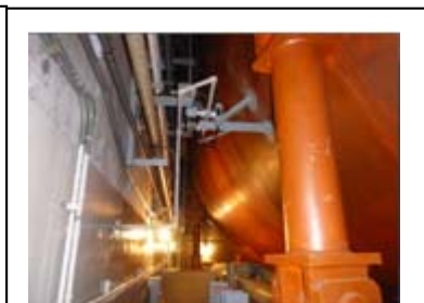
図 5.1.5 S/C 下部・ トーラス室の壁面 (濁った水に浸かっている)
